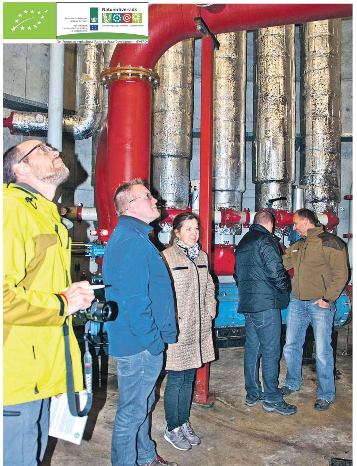
Dansk besøg i maskinrummet under Tysklands største Sauter-anlæg, der producerer 2000 m 3 gas i timen. Størstedelen opgraderes til naturgasnettet.
